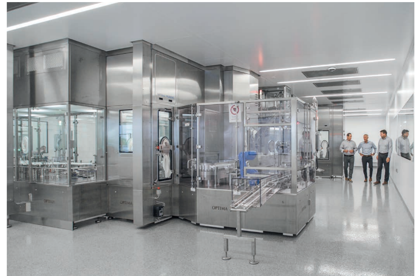
↑ Die Ergänzung einer Gefriertrocknungsanlage als ein weiterer Produktpfad ist anlagenseitig vorbereitet.
