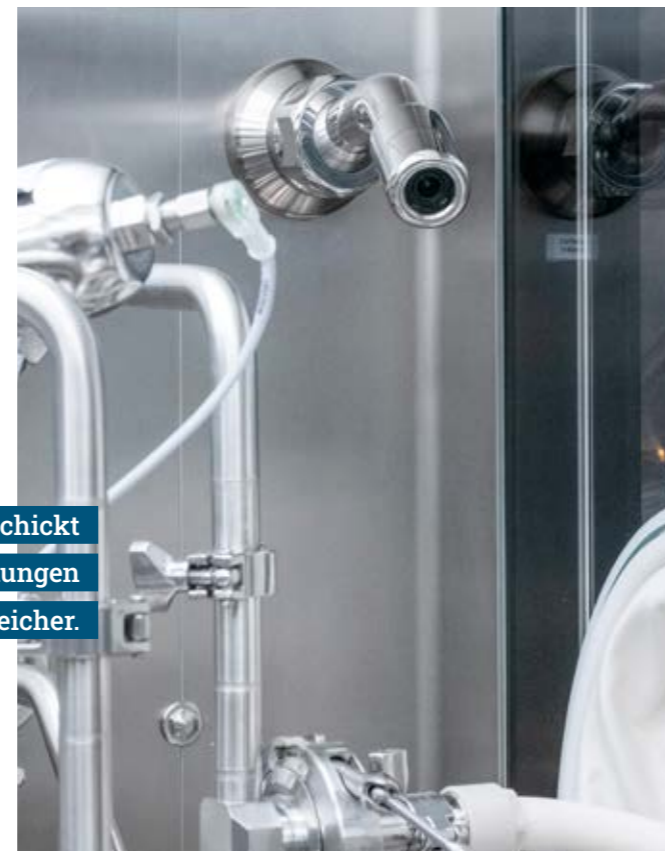
↑ Video-Monitoring: Die Kernprozesse und Prozesse mit hoher Kritikalität sind jederzeit nachvollziehbar, ob für differenzierte Störungsanalysen oder die Dokumentation von Eingriffen.
